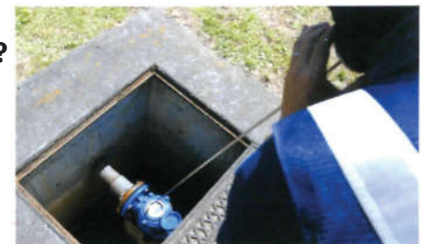
Khảo sát rò rỉ tại các đồng hồ đo nước.
